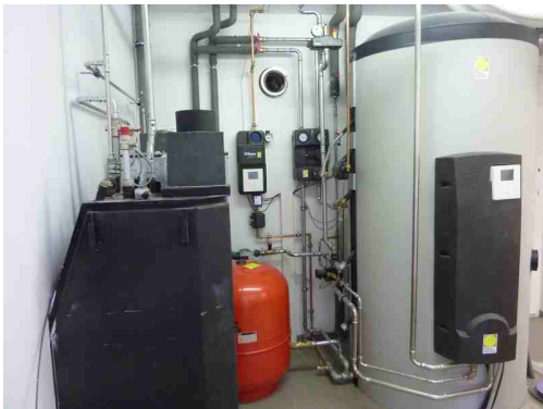
Wärmeversorgung mit Frischwasser-Wärmespeicher Expresso 1100 und Kaminofen (Kessel)
