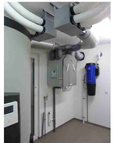
Lüftungs- und Staubsauganlage
