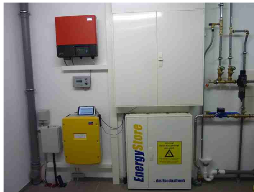
Stromversorgung mit Verteilerschrank, Stromspeicher, Wechselrichter und Laderegler.
